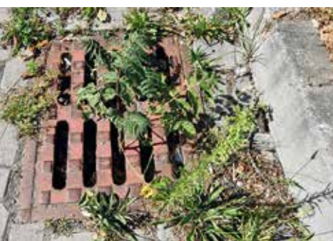
Pleveli pleveli u kanalizační vpustě
